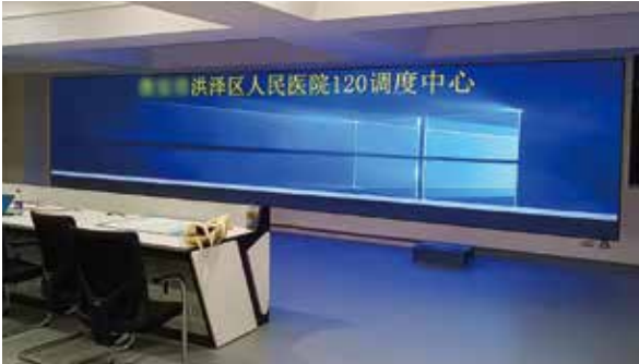
某医院调度中心
